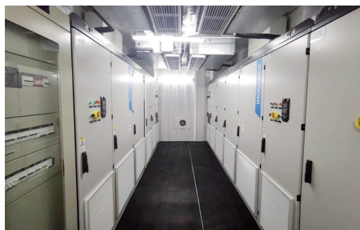
广州港南沙海港集装箱码头岸基变频电源
