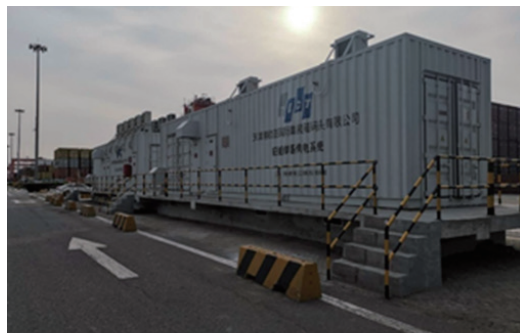
天津港欧亚国际集装箱码头岸基变频电源
