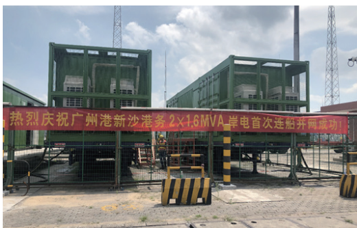
广州港南沙港务船舶岸基变频电源
