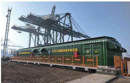
天津港太平洋国际集装箱码头岸基变频电源
