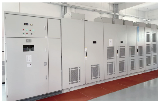
上海盛东国际集装箱码头岸基变频电源
